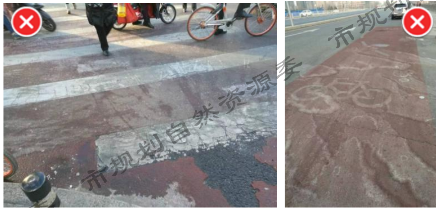
图 6-22 彩铺破损、不耐脏，影响古都风貌的案例
